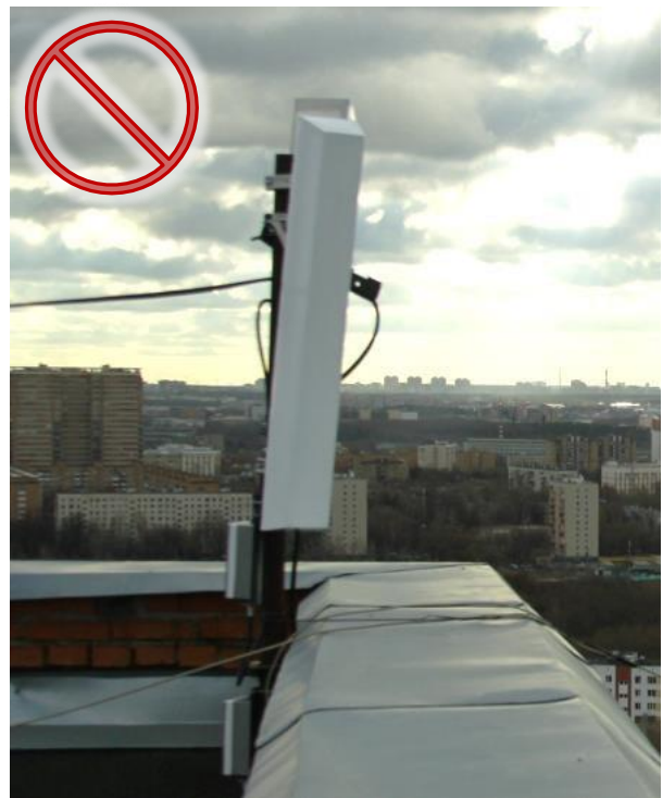
Sektorska antena instalirana blizu parapeta i nedovoljnom visinom za instalaciju.
