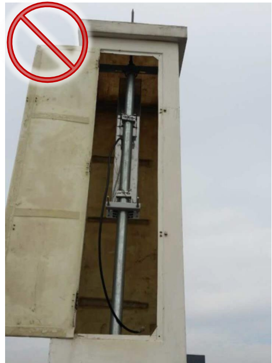
Sektorska antena ugrađena u zaštitno kućište sa metalnim okvirima.
